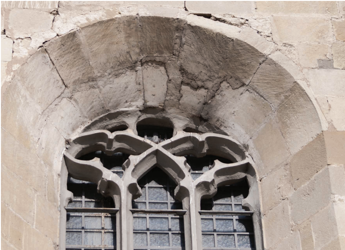
17. Kościół św. Jana Chrzciciela w Skalbmierzu, maswerk w południowo-wschodnim oknie prezbiterium. Fot. Wojciech Sowała
