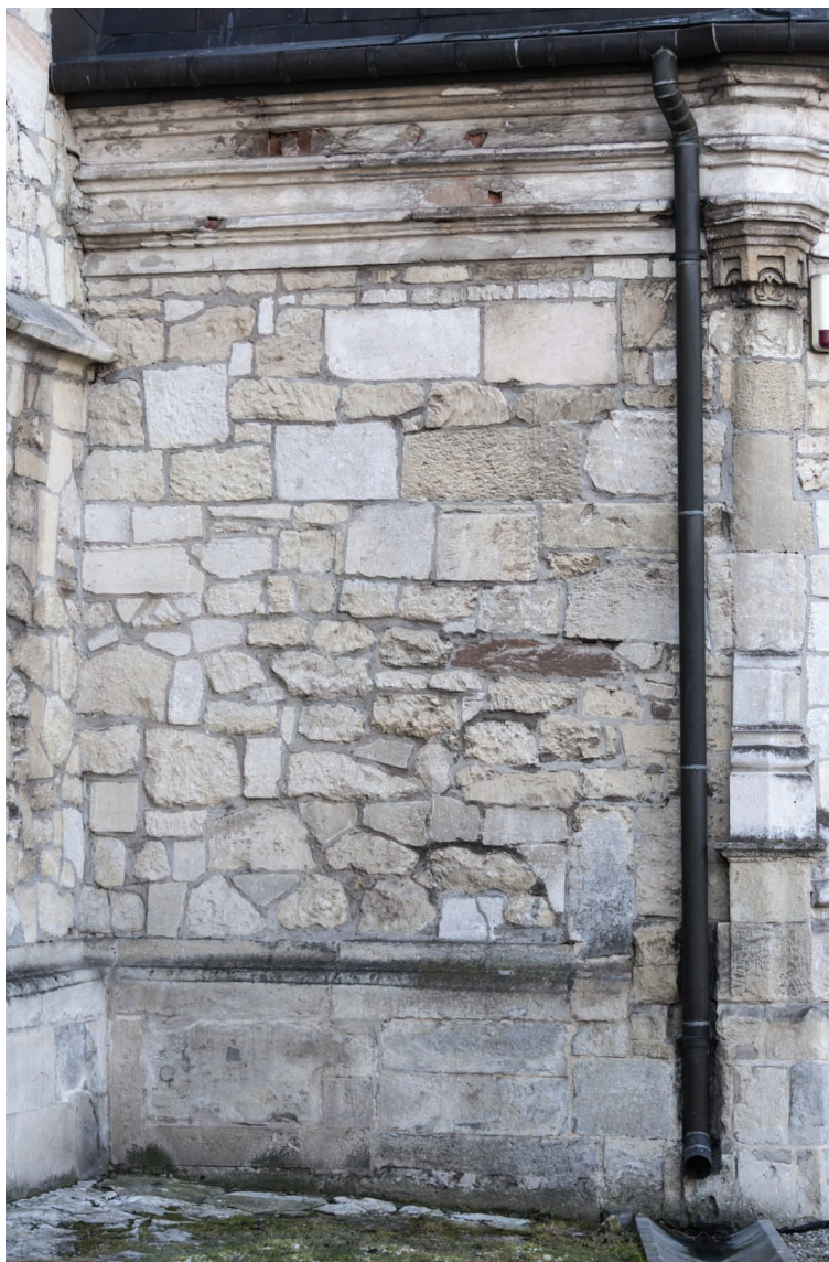
11. Kościół św. Jana Chrzyciela w Skalbmierzu, styk ścian północnej nawy i kruchty. Fot. Wojciech Sowała
