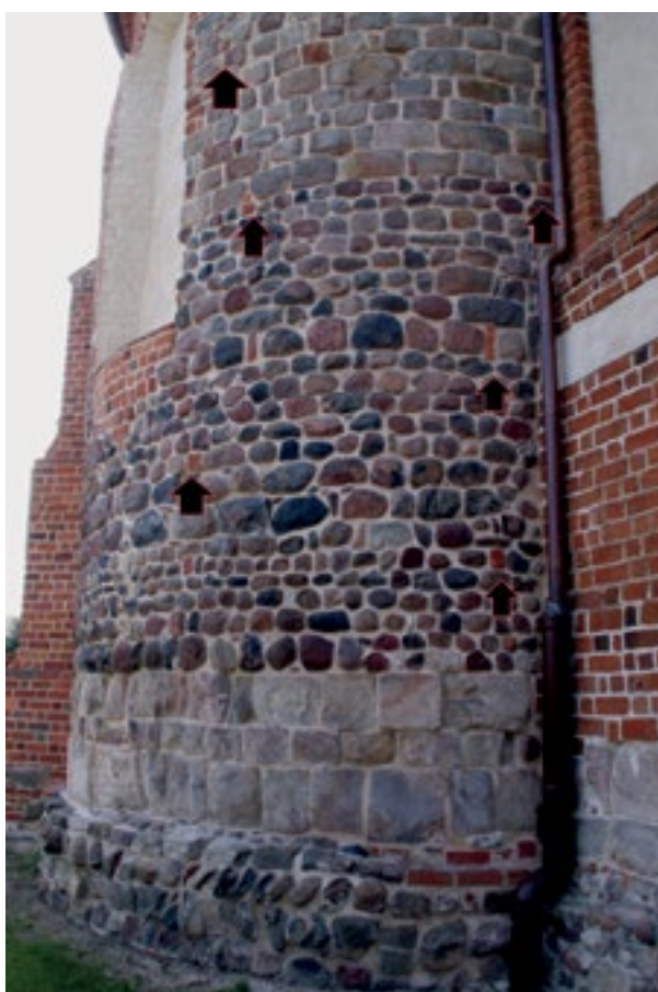
16 Kazimierz Biskupi, kościół św. Marcina, fragment elewacji apsydy na styku z zakrystią. Oprac. Adam Soćko Pionowymi strzałkami oznaczono inkluzje ceramiczne.
