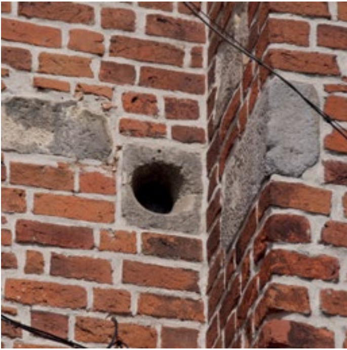
19 Kazimierz Biskupi, kościół św. Marcina, ciosa romański z drążonym otworem – okulusem, pierwsze od zachodu przeszło ściany nawy południowej. Fot. Adam Soćko
