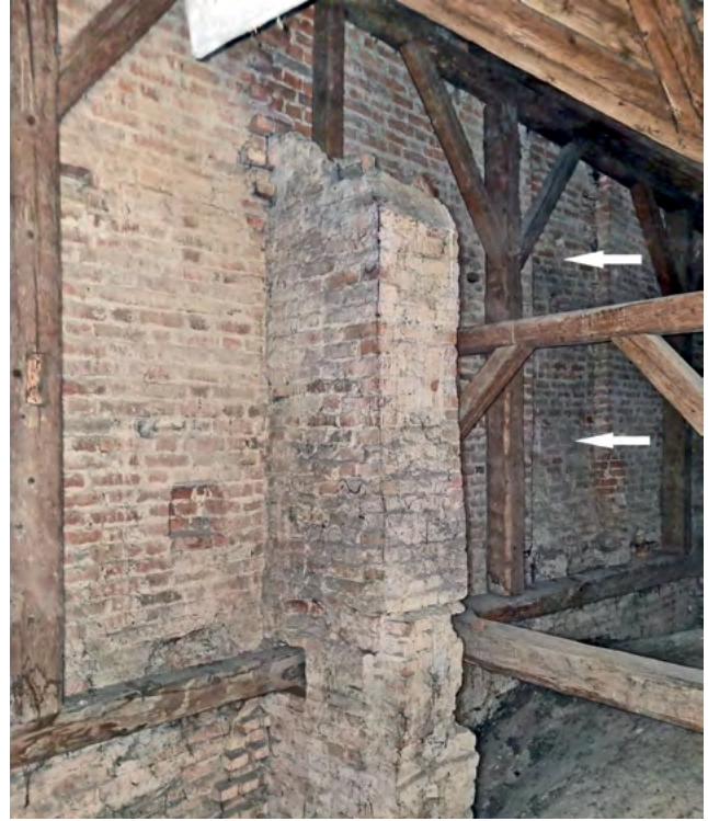
27 Przeworsk, kościół farny (d. Bożogrobców), przypora północnej ściany nawy głównej od strony strychu. Strzałkami oznaczono wnękę odciążającą. Fot. Jakub Adamski
