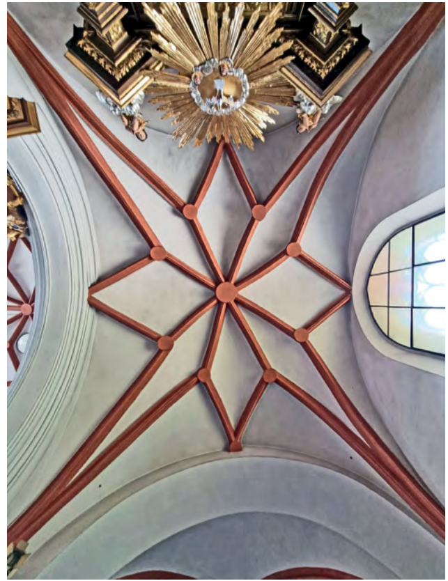
36 Przeworsk, kościół farny (d. Bożogrobców), sklepienie pierwszego od wschodu przęsła nawy północnej. Fot. Jakub Adamski
