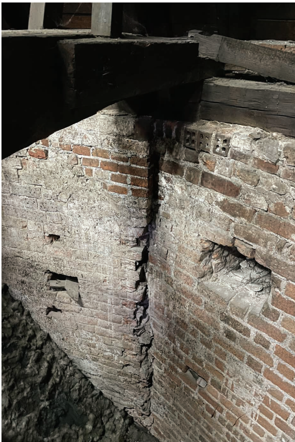
24. Sandomierz, kolegiata (ob. katedra), rozwarstwienie murów prezbiterium i apsydy na poziomie poddasza. Fot. Adam Kossakowski
